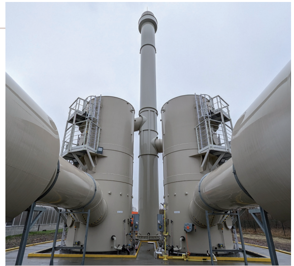
AyraScrub™ est un procédé efficace pour éliminer les gaz acides, les COV et d'autres polluants présents dans les effluents gazeux.
